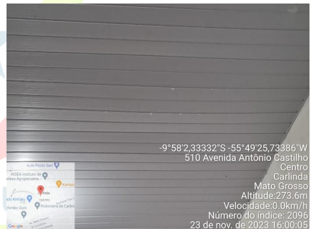
FOTO 10: Goteiras em forro de PVC indicando possíveis problemas na cobertura.
