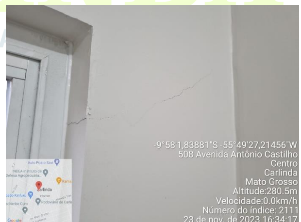
FOTO 12: Trinca na alvenaria de vedação indicando possível falta de verga sobre o vão de porta.
