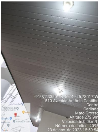
FOTO 9: Forro de PVC selado faltando a devida fixação.
