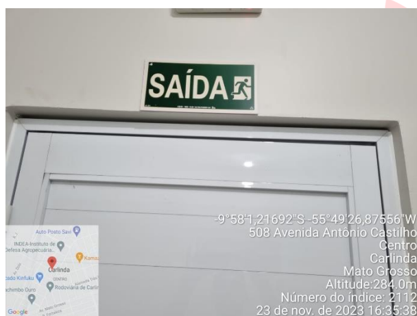
FOTO 1: Porta sem vedação entre a alvenaria e esquadria.
