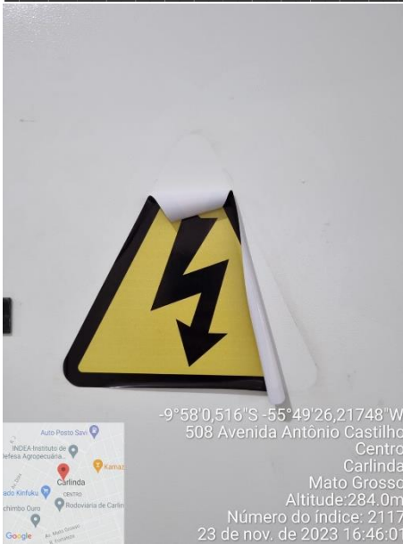
FOTO 3: Adesivo de advertência descolando.
