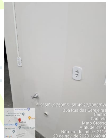
FOTO 6: Pintura em alvenaria com manchas e/ou tonalidade divergente da usada na obra.
