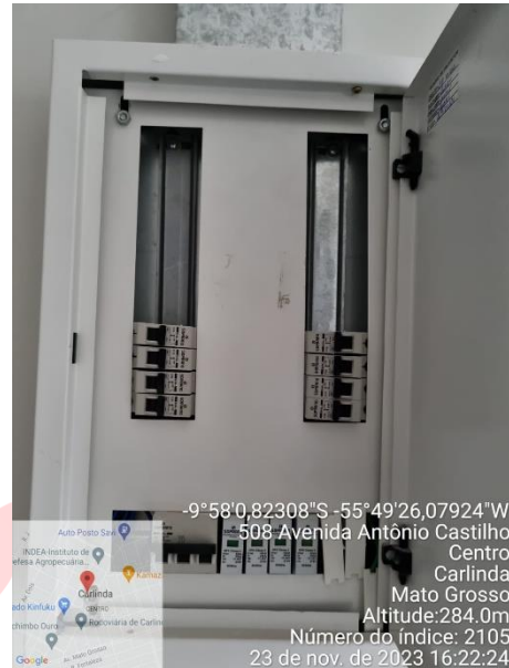
FOTO 4: Quadro de distribuição sem descrição de indicação para disjuntores.
