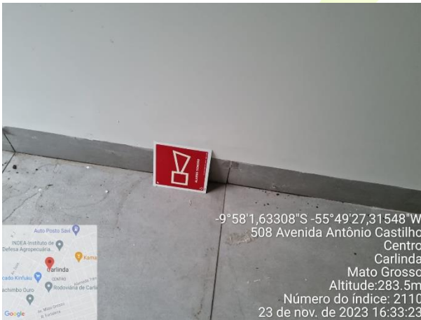
FOTO 5: Placa de alerta audiovisual descolada.
